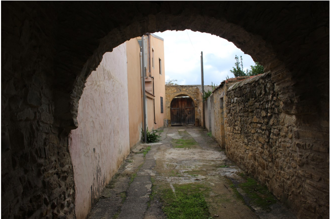
2 - Vista del vico dal portico di accesso, visibile in primo piano lo stato di deterioramento della pavimentazione presente.
