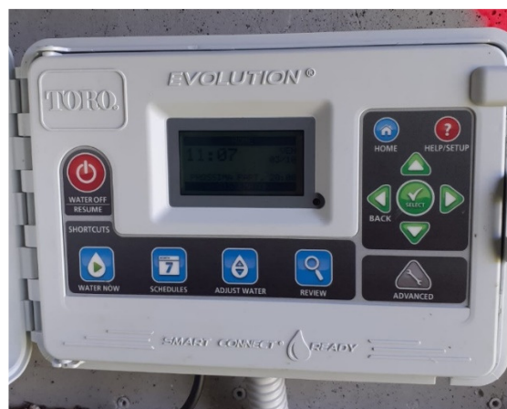
Figura 4. Centralina di programmazione (entro il vano tecnico)
