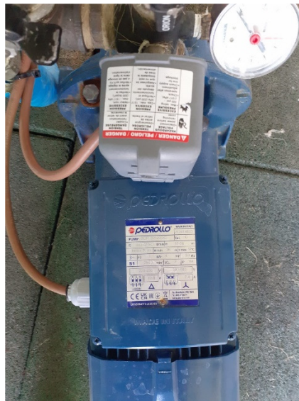
Figura 3. Elettropompa per pressurizzazione (entro il vano tecnico)
