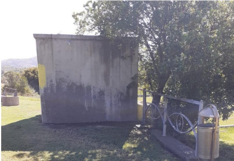
Figura 2. Vano tecnico gruppo di pompaggio
